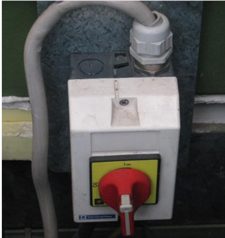
Resim 2.15: Yürüyen merdivende kullanılan ana şalter
