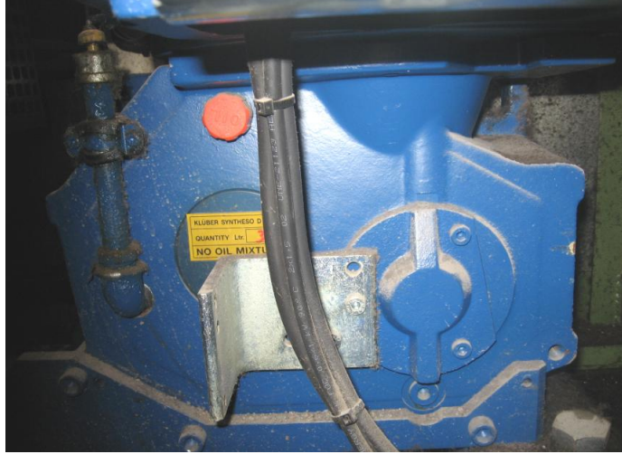
Resim 3.5: Yürüyen merdiven redüktörü ve yağlama girişi
