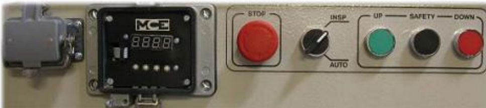
Resim 2.26: Yürüyen merdiven/yol kontrol panosu dış kontrol butonları ve arıza kod göstergeleri
