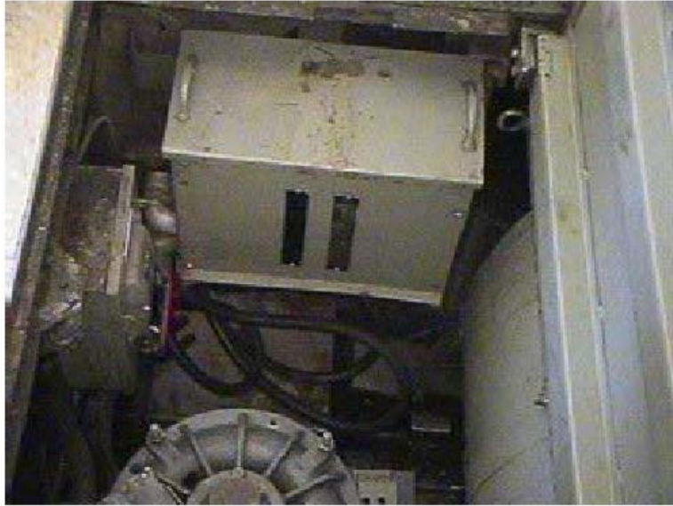
Resim 2.2: Yürüyen merdiven makine dairesi
